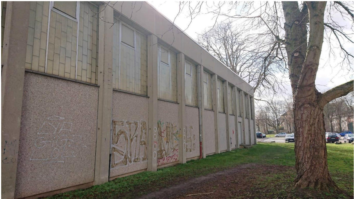
Abb. A1: Beispielhaft: intakte NW-Fassade der alten Sporthalle mit wenig bis keinen Unterschlupfmöglichkeiten für Vögel/Fledermäuse
